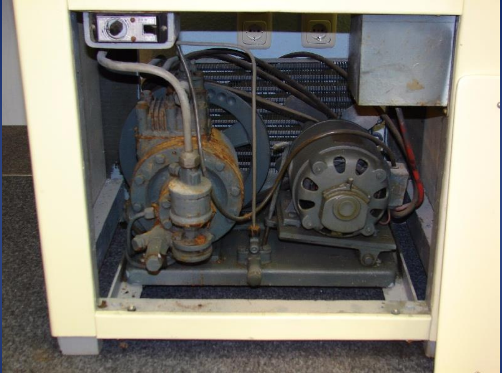
Maschinenabteil mit dem in Lizenz gefertigten Norge-Rollkolbenverdichter
