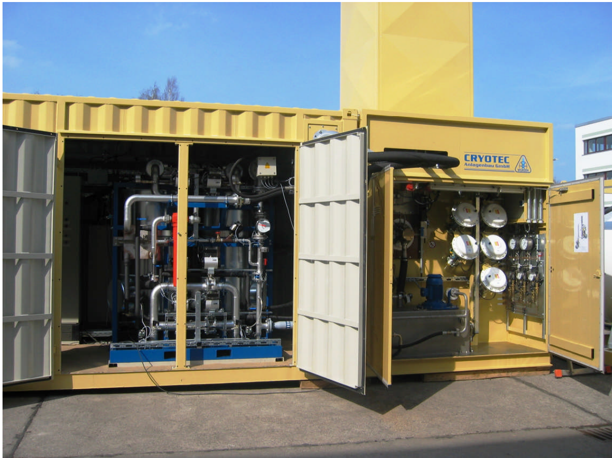
ONL 40 T (Containerbauweise) Molekularsiebbatterie und Schalttafel der Cold Box
