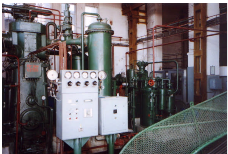
Luftzerlegungsanlage OM 250 Luftverdichter
