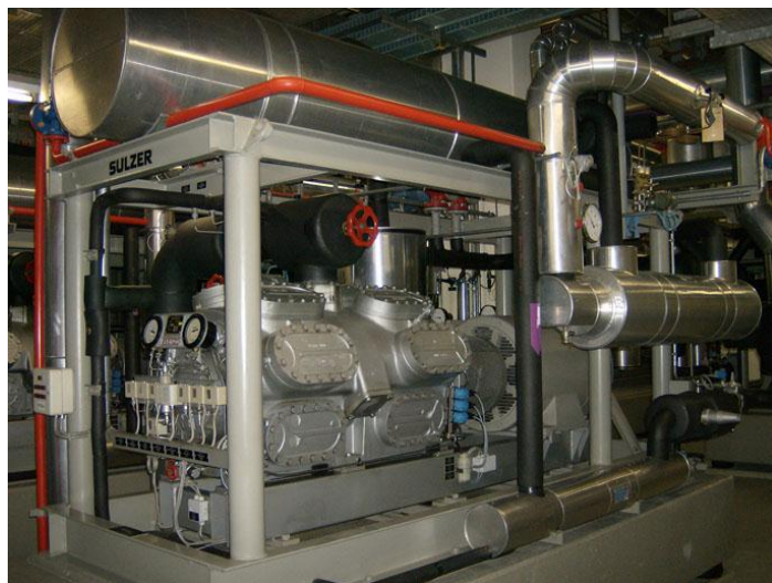
Bild 9: Eine der vier 440 kW Wärmepumpen beim Bahnhof Luzern (1984) [Axima, Kriens]
