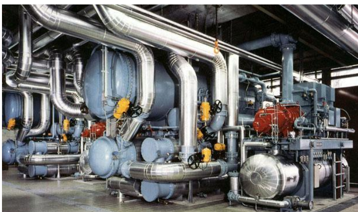
Bild 10: 7.8 MW Ammoniakwärmepumpensystem an der EPFL, 1986 [Friothersm 2008]
