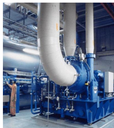
Bild 11: Eine von sechs 30 MW Sulzer Wärmepumpen der Stockholmer Fernheizung (1985) [www.friothersm.ch]
