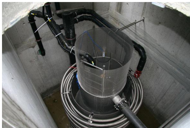
Bild 13: FEKA-Tank zur Wärmerückgewinnung Schmutzabwasser [Kalberer, FEKA-Energiesysteme, Bad-Ragaz]
