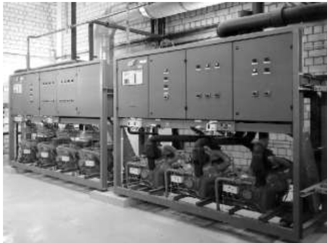
Verbundkälteanlage in einem Supermarkt
