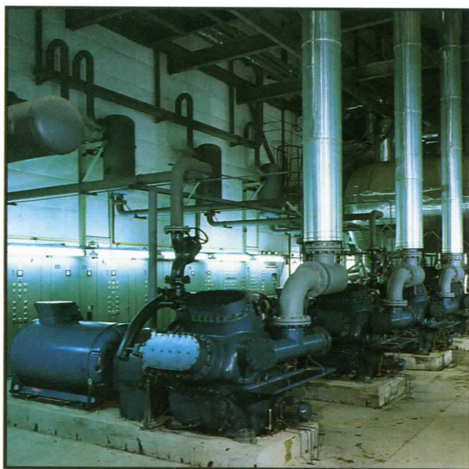
Kältemaschinenhaus der Bob- und Rennschlittenbahn in Altenberg
