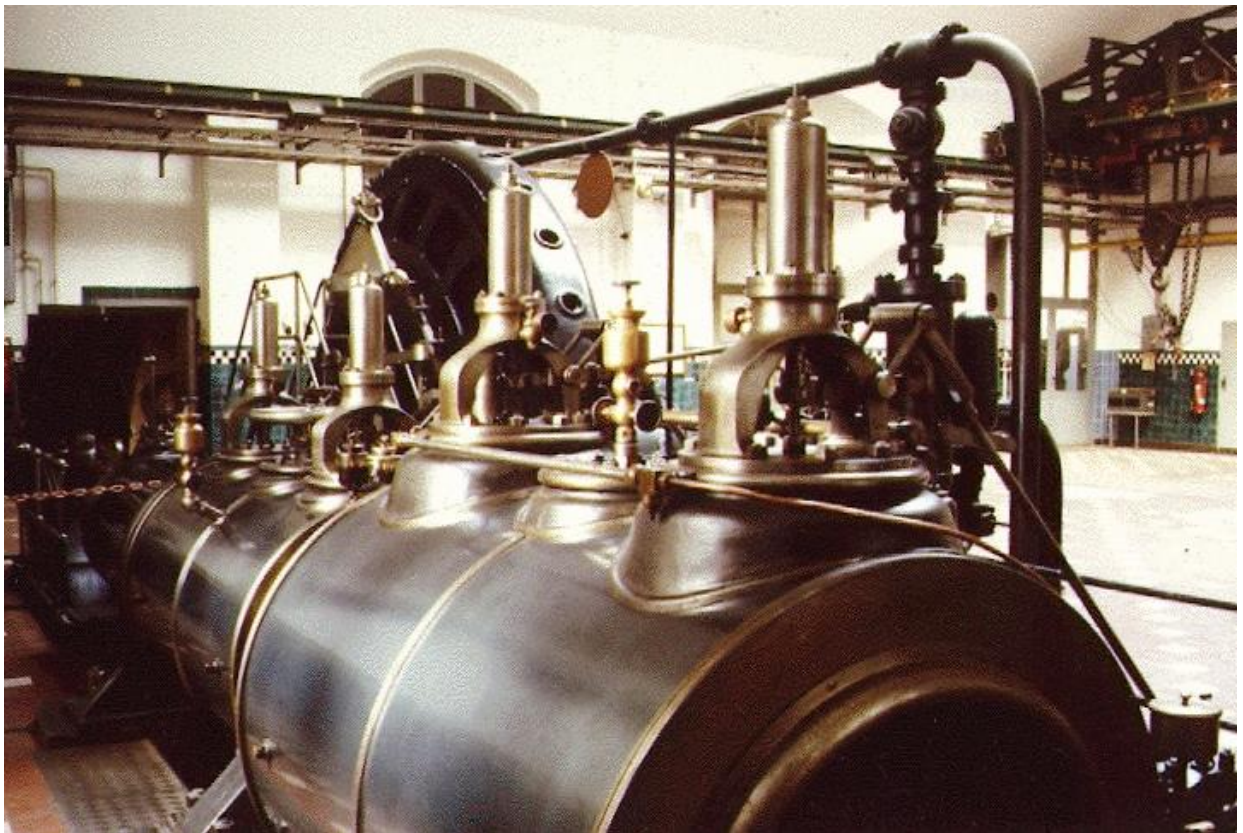
Die Sulzer-Dampfmaschine war bis 1972 für Strom- und Kälteversorgung zuständig. Sie trieb aber auch alle Pumpen und Rührwerke über Transmissionsriemen an.
